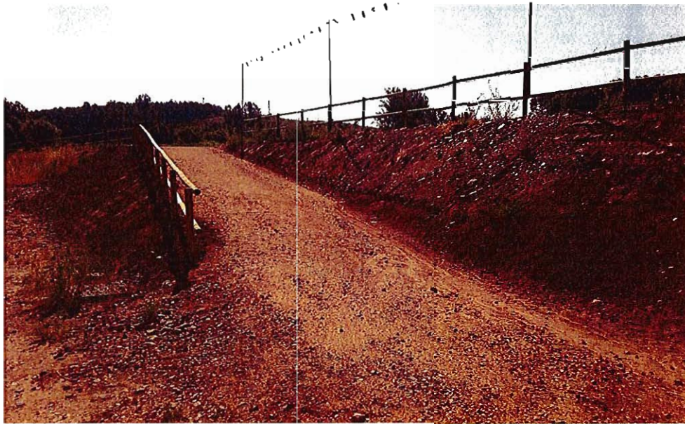
Rampa de acceso desde la parcela a la zona del embalse del azud
