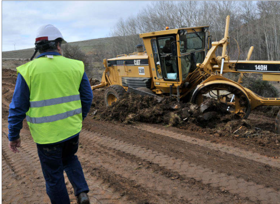
Inicio de las obras preparatorias de la depuradora a comienzos de mes. VALENTÍN GUISANDE
