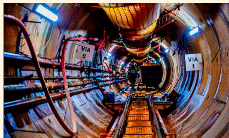
El túnel. El impresionante túnel que conectará la EDAR con la ciudad ya ha alcanzado los 2,2 kilómetros, casi la mitad de lo previsto. En apenas 3 metros se han habilitado la vía para llegar a la tuneladora, los cables de energía, la manguera de ventilación. Y ahí trabaja un equipo de 12 personas.
