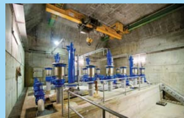
Válvulas de los desagües de fondo
