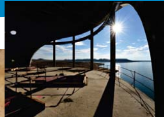
Interior estación de bombeo
